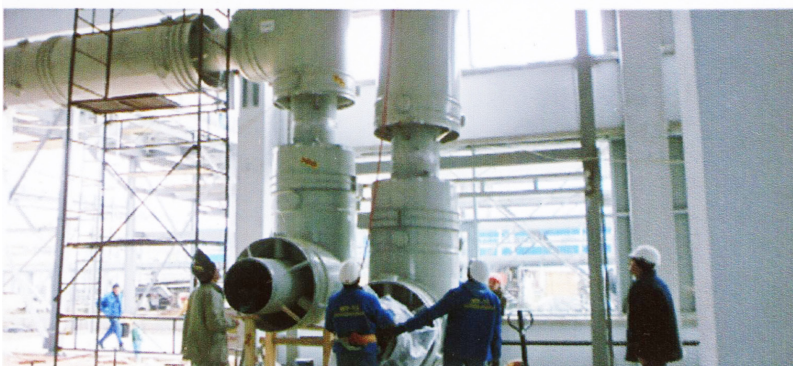
Обладнання Дністровської гідроакумулюючої електростанції (ГАЕС). 2014 р.
